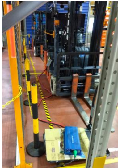
非常用電源（リフト給電）
