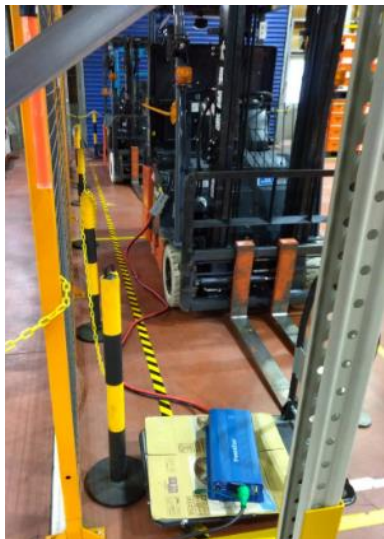
非常用電源(リフト給電)
